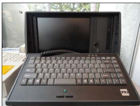
Figura 3. Subsistema periférico- PC industrial
